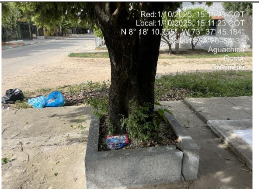
IMAGEN 2-Primer árbol, que ha causado afectaciones a la infraestructura de la vivienda. FOTO. autor
