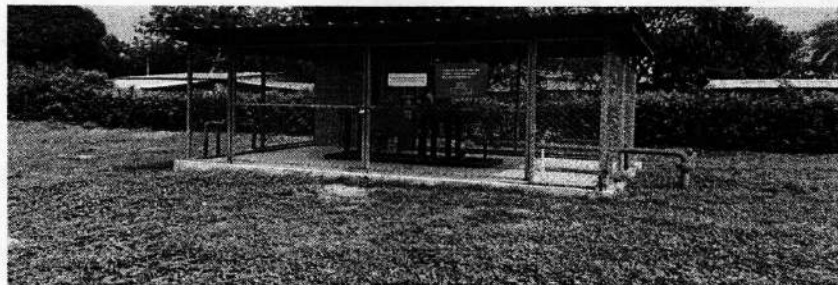
Imagen 7. Vista general área de Válvula de cierre de gas. Fuente: Propia
