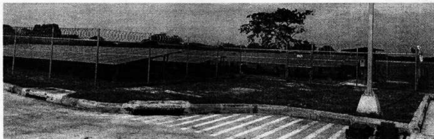
Imagen 12. Vista general paneles solares. Fuente: Propia
