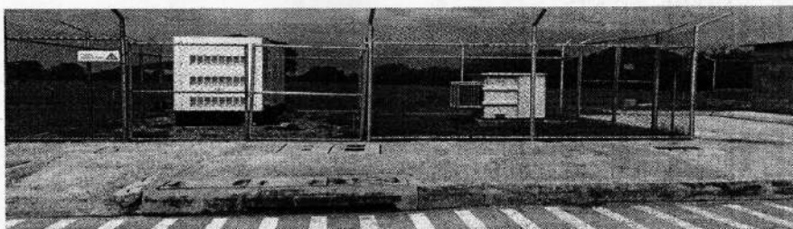
Imagen 10. Vista general sistema eléctrico de almacenamiento de tanques de gas. Fuente: Propia
