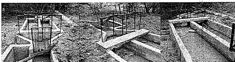
Imagen. Vista general sistema de desarenador
