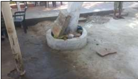
Fig. 7 Detalle de materia fisurada.
