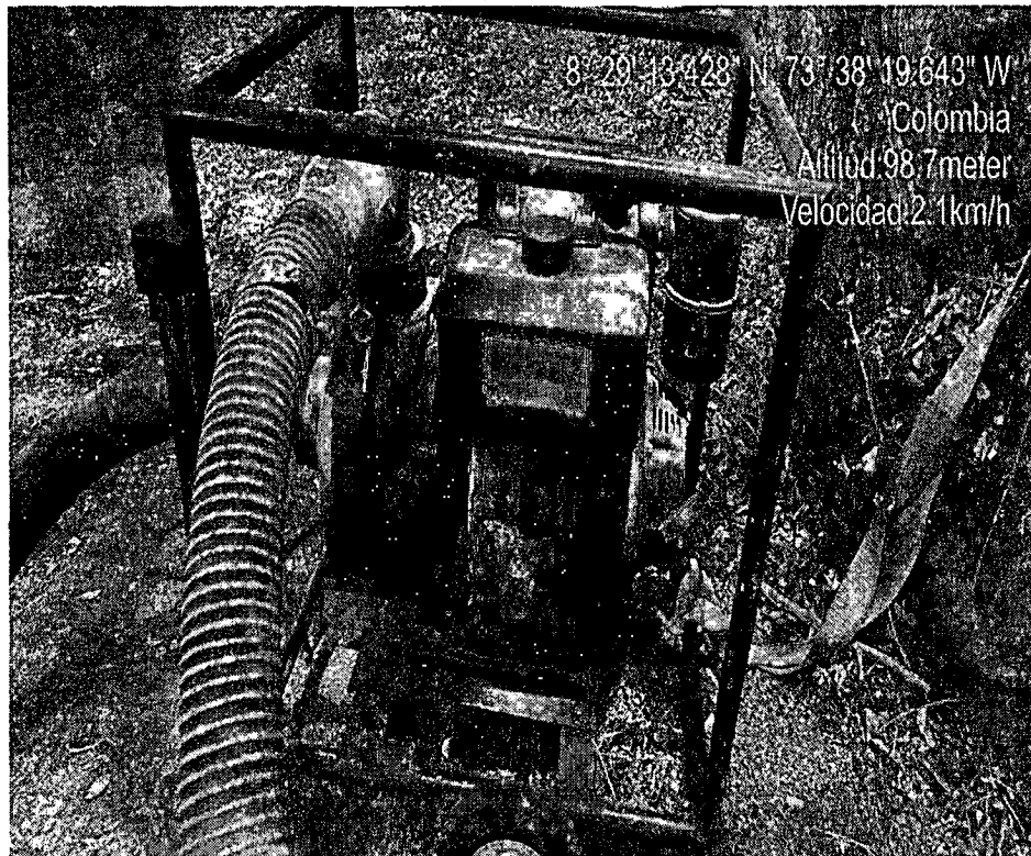
Imagen No 2. Equipo de Bombeo
