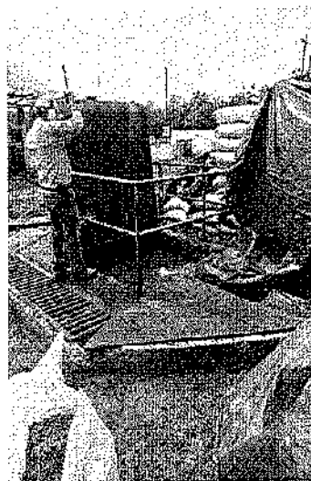
Imagen. Vista general trampas de grasas usado como sistema primario del tren de tratamiento.
