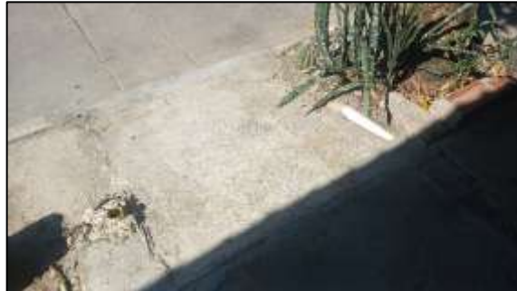
Fig 3. Piso fisurado entre bordillo-andén
