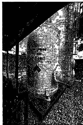
Imagen. Vista general filtro químico
