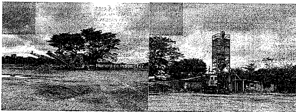
Imagen 3 y 4: Vista general, planta trituración y equipo dosificador de concreto.
