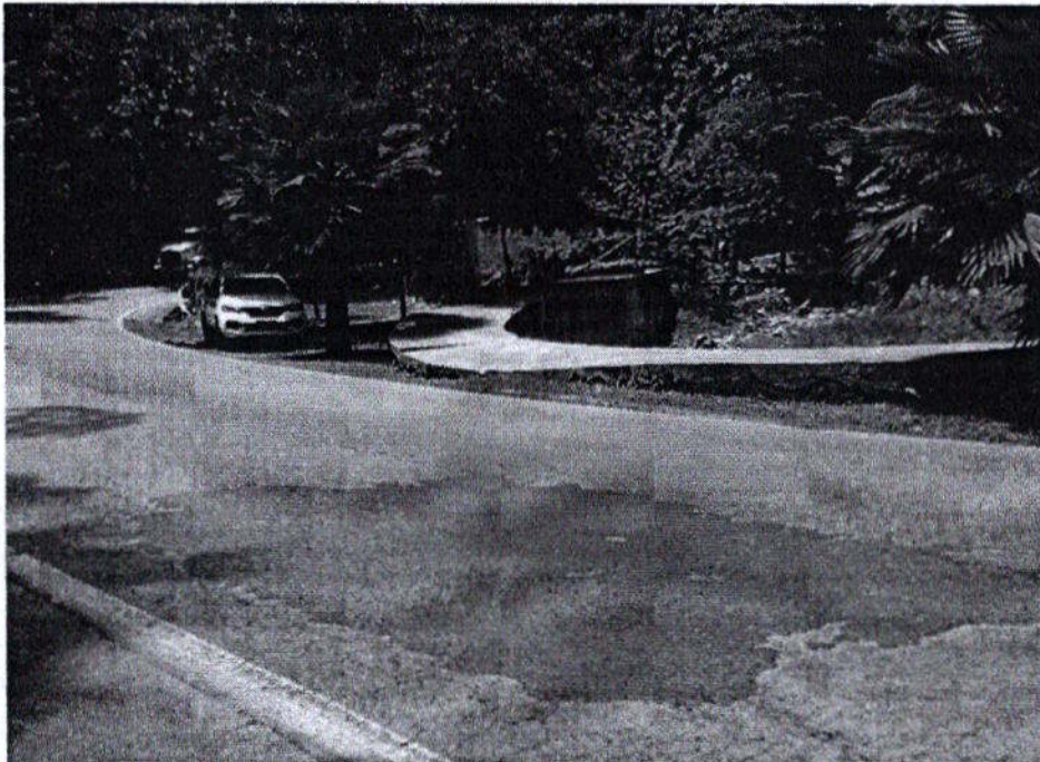
Imagen 2. Muro de concreto en PR 16+700 RN 7007 vía Aguaclara – Río de Oro, Cesar. Fuente: Autores.
