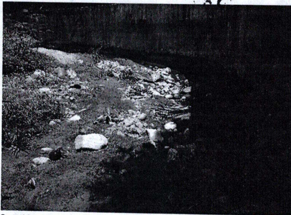
Imagen 4. Se evidencia socavación de la base del gavión revestido de concreto. Fuente: Autores.
